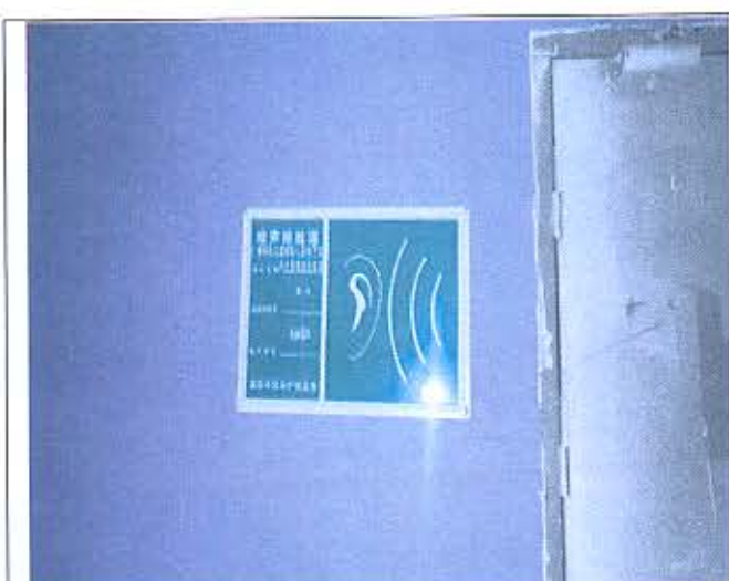
水泵房 3 噪声标志牌
